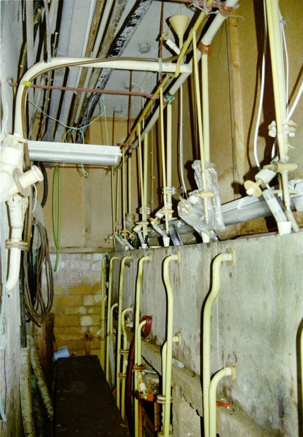
Sistema impianto acqua marina, per le vasche
