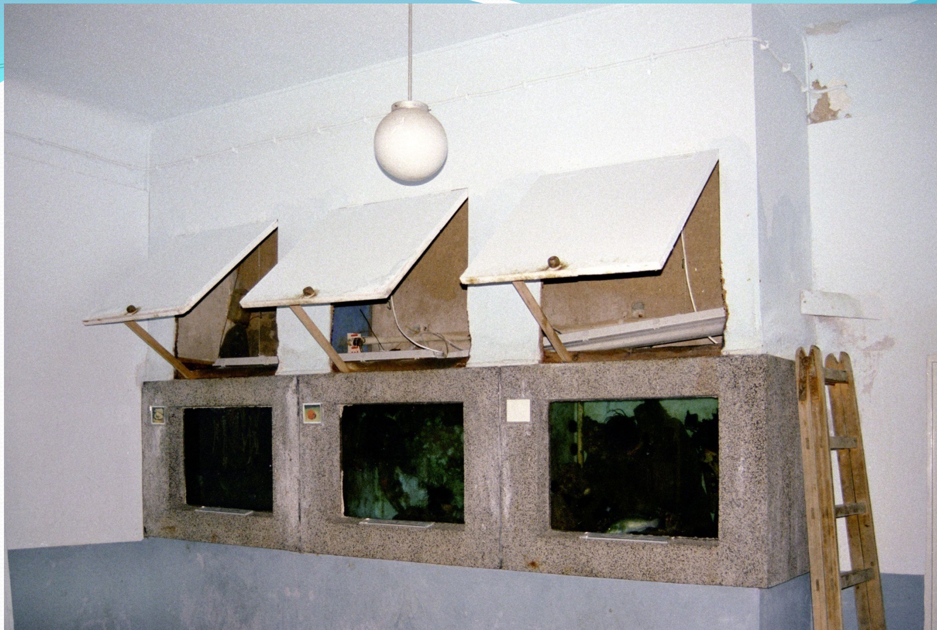
Ventilazione delle vasche
