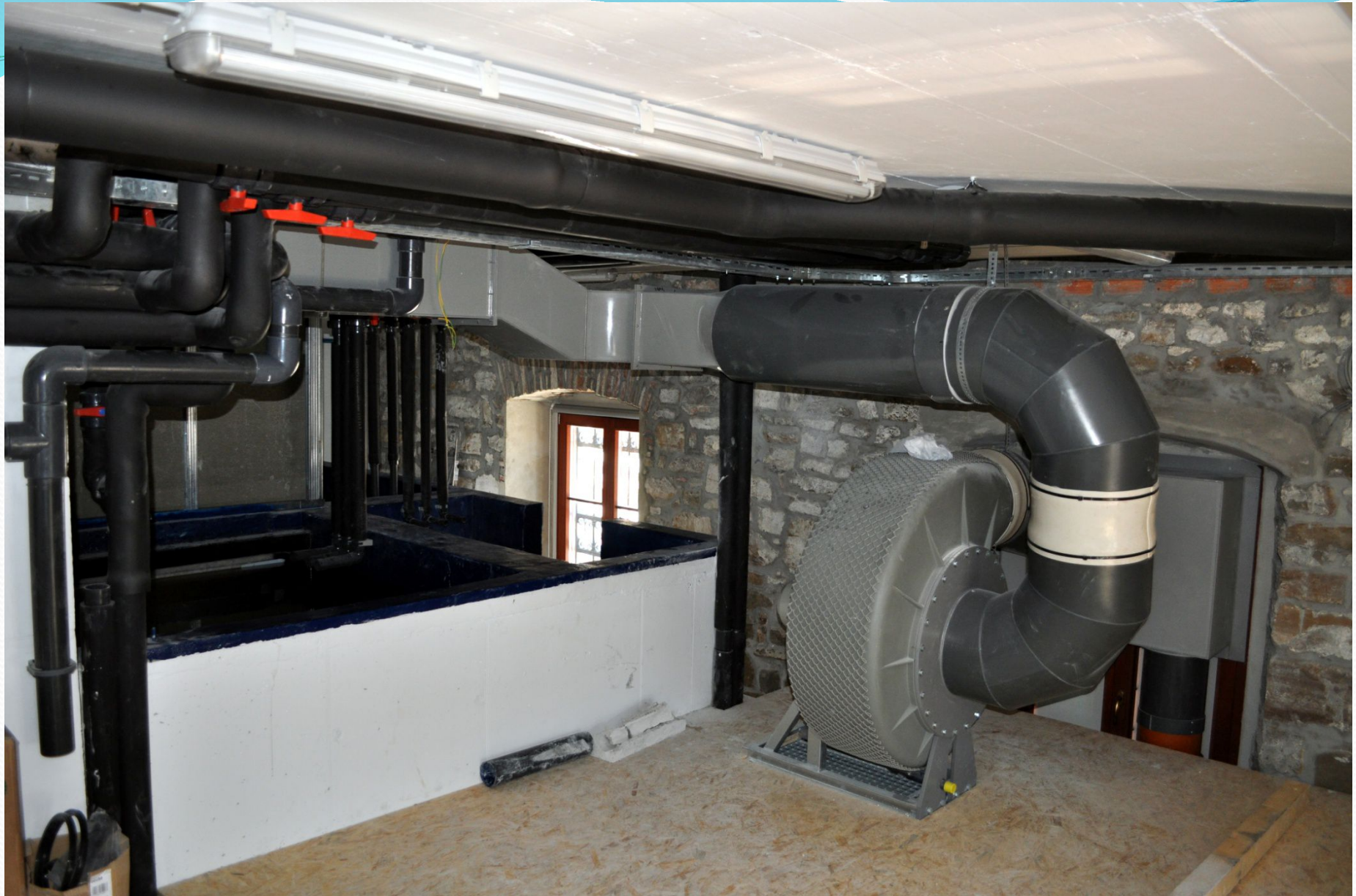
Sistema di ventilazione dei locali
